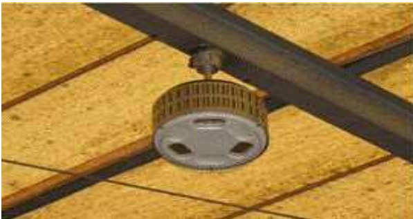
LED電灯(テント倉庫)
